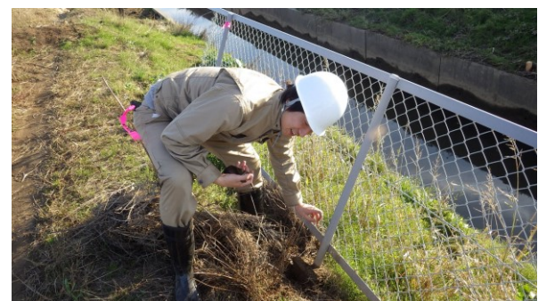
倒伏したフェンス支持部を調査する様子
