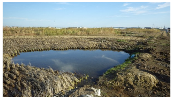
渋井川堤防決壊部堤内側の様子
