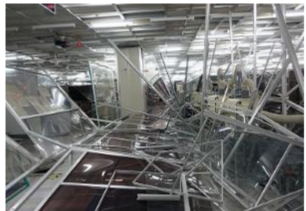
被災後のクリーンルームの写真
