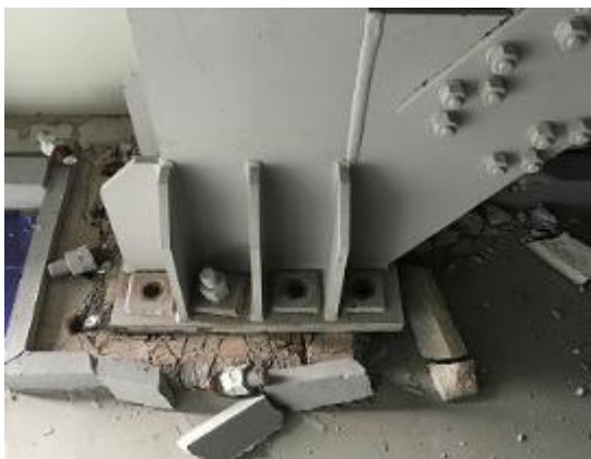
固定ボルト破断の写真
