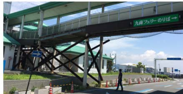
熊本港フェリーターミナル施設の被害様子
