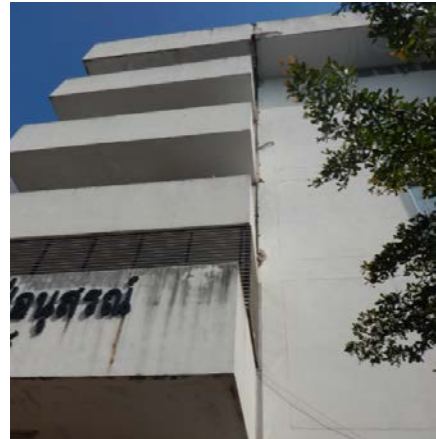
被害を受けた県立病院
