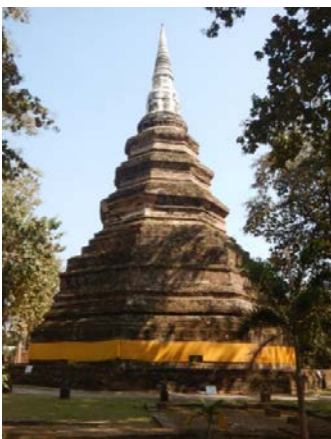
被害を受けたパゴダ (上の白い部分は新しいもの)
