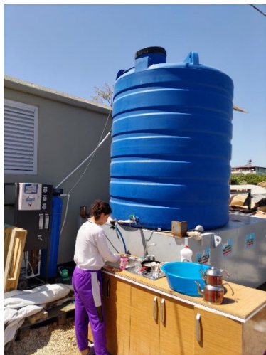
衛生面に配慮された浄水タンクと排水機構
