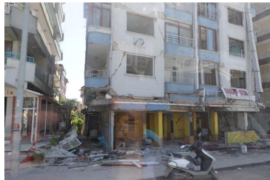
2階が層崩壊した建物（アンタキヤ）
