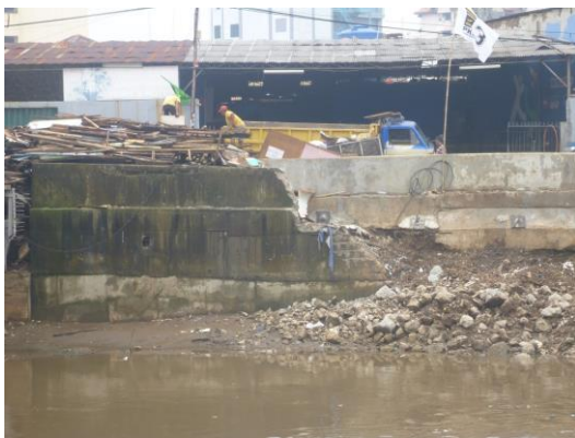
斜面崩落による堤防破壊 （洪水前に発生・応急復旧，カレット水門上流）
