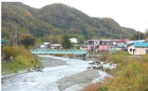
護岸が壊れたままの小本川（小川地区）
