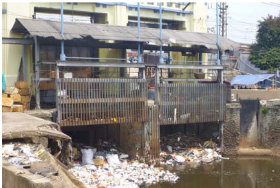
マンガレイ水門（チリウン川）に堆積するゴミの様子
