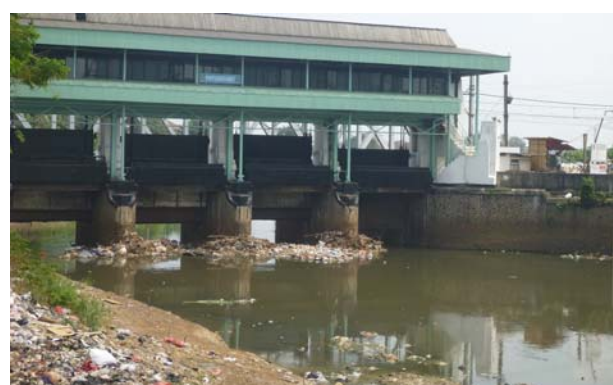
カレット水門（西排水路）に堆積するゴミの様子
