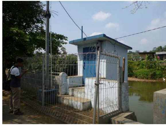
カトランパ水門直上流の水位観測テレメトリーシステム
