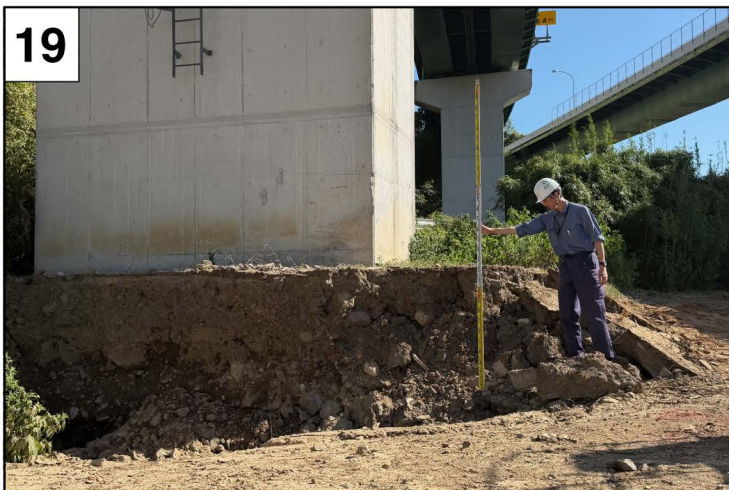
19 九州自動車道八代ジャンクション付近の橋脚を変位させる地震断層。最大 1.5m の隆起と右横ずれを確認。7 月 31 日遠田撮影。
