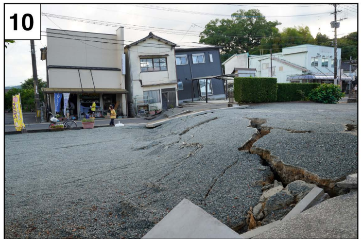
10 断層の上下変位で傾いた家屋。宇城市小川町小川。7月29日鳥井撮影。
