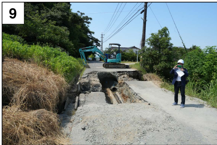
9 水道管を破断させた地震断層。宇城市小川町南部田。バックホウ側が隆起。人物側が低下。右横ずれもともなう。8月2日遠田撮影。
