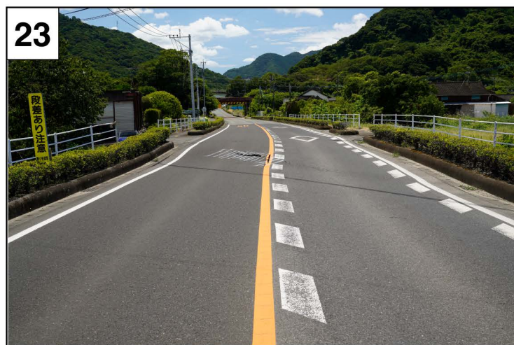
23 球磨川左岸の八代市豊原上町。国道 219 号線を横切る地震断層。7 月 29 日鳥井撮影。
