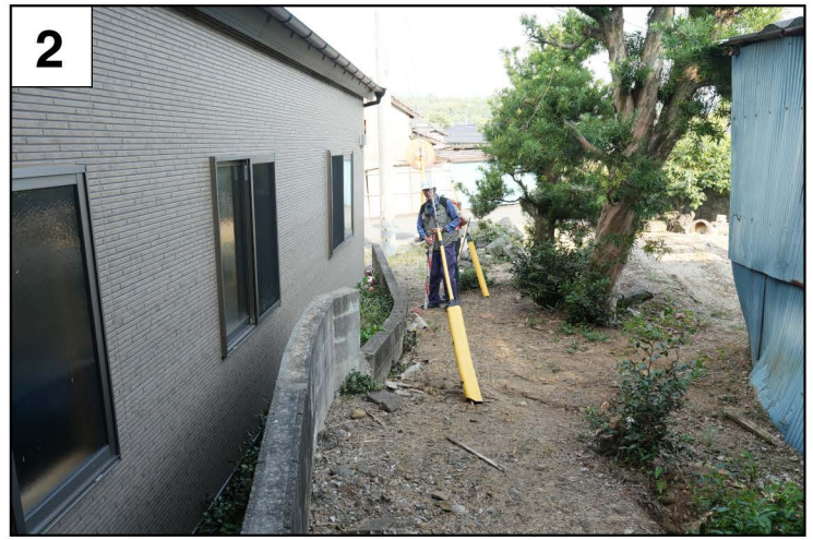
御船町高木のブロック塀の右横ずれと新鮮な雁行クラック。2016年地震、その後の余効すべりで当初から80cm以上屈曲したが、2026年地震でもわずかに変位。新鮮な雁行クラックと塀の破壊がみられる。8月2日遠田撮影。
