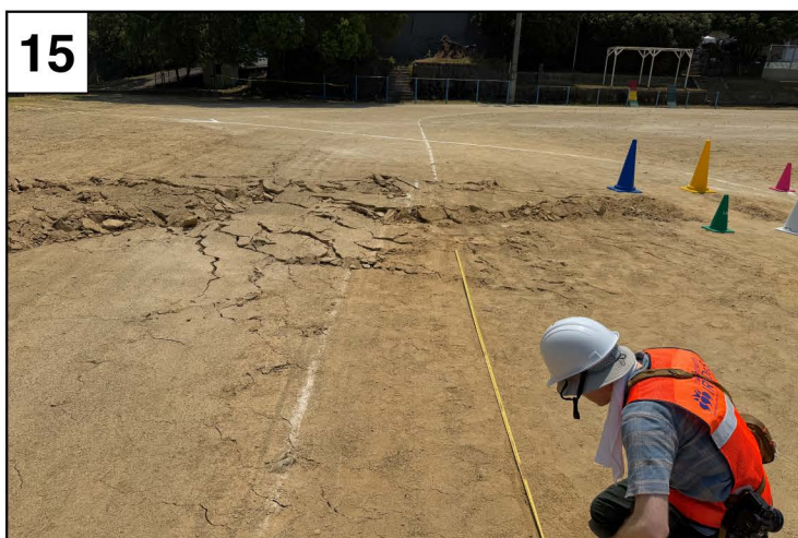
八代市岡町の八代小学校龍峯小学校の校庭を横切る地震断層。運動場の白線トラックが約 100 cm 右横ずれしている。8月3日遠田撮影。
