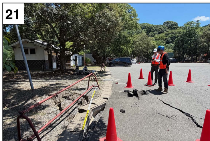
21 八代神社の駐車場脇の排水路の右横ずれ。上下変位も顕著で東側隆起。7 月 31 日遠田撮影。
