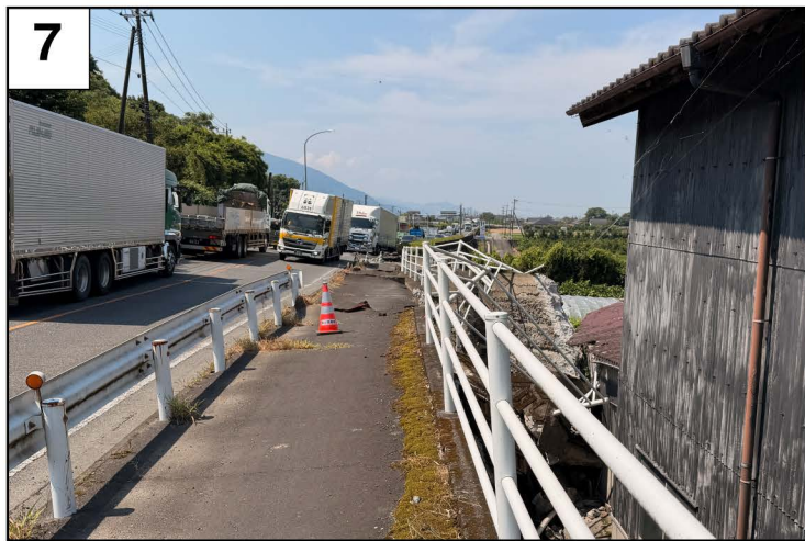
7 国道3号線を横切る地震断層。上下変位も顕著で、スローダウンを余儀なくされる車両。8月3日遠田撮影。
