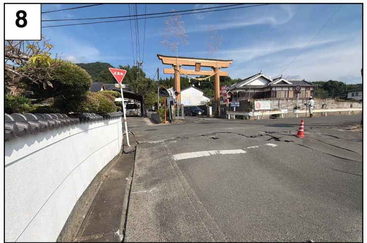
8 宇城市小川町南部田の守山八幡宮前の道路を横切る地震断層。左手の白壁と排水路ブロックが右横ずれしている。8月1日遠田撮影。
