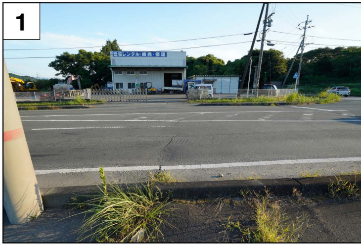
御船町土山の道路を横切る地震断層。今回の地震断層帯の北限とみられる。2016年熊本地震、その後の余効すべりでも横ずれした。今回、新鮮なクラックが生じる。道路は約9年前に再舗装。7月28日鳥井撮影。
