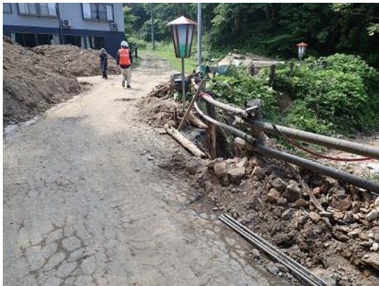
建物敷地内への土砂流入（白鷹町）
