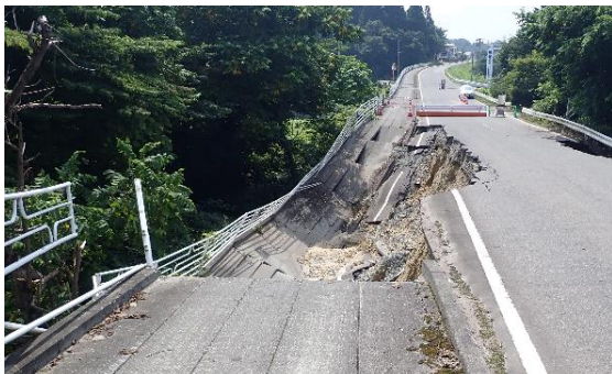
道路路肩の崩壊（月府川大橋付近）
