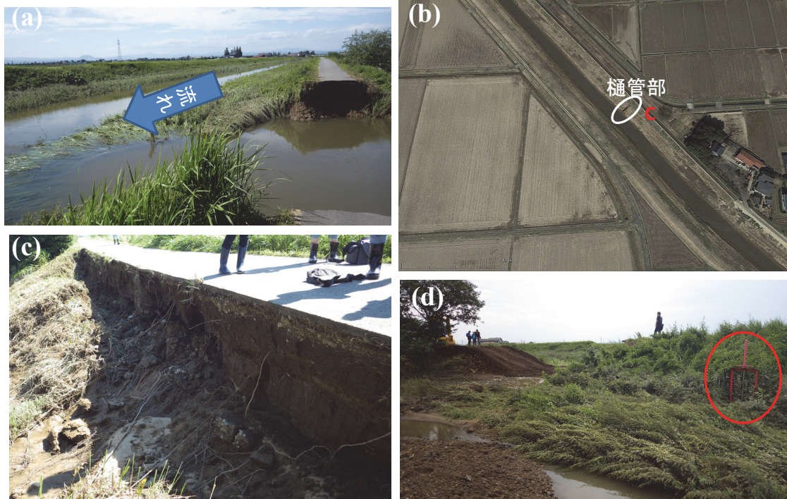
図-5 破堤地点Cの状況
