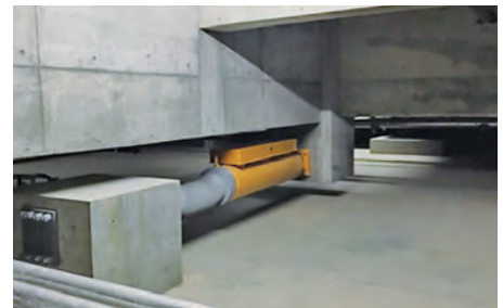
地下部分のピットとダンパー
