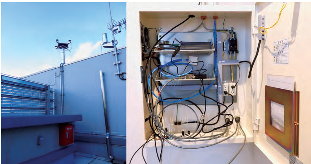
屋上に設置された GNSS アンテナと建屋内の観測機器設置箱（2014 年 12 月 25 日撮影）
