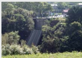
被害を受けた阿蘇大橋（現地調査にて撮影）
