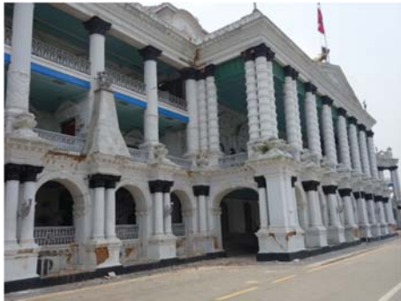
政府中枢建物も被災
