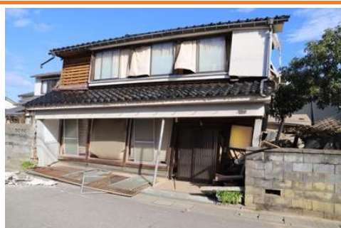
1層の傾斜(全壊)
