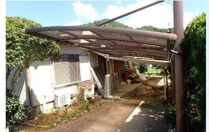
②地表断層、建物被害（神社横）
