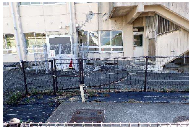
④地表断層、建物被害（興善寺町）
