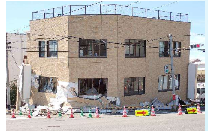
⑤店舗建物、1層崩壊
