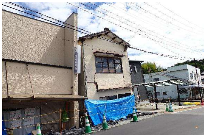
④地表断層、建物被害（小川町）
