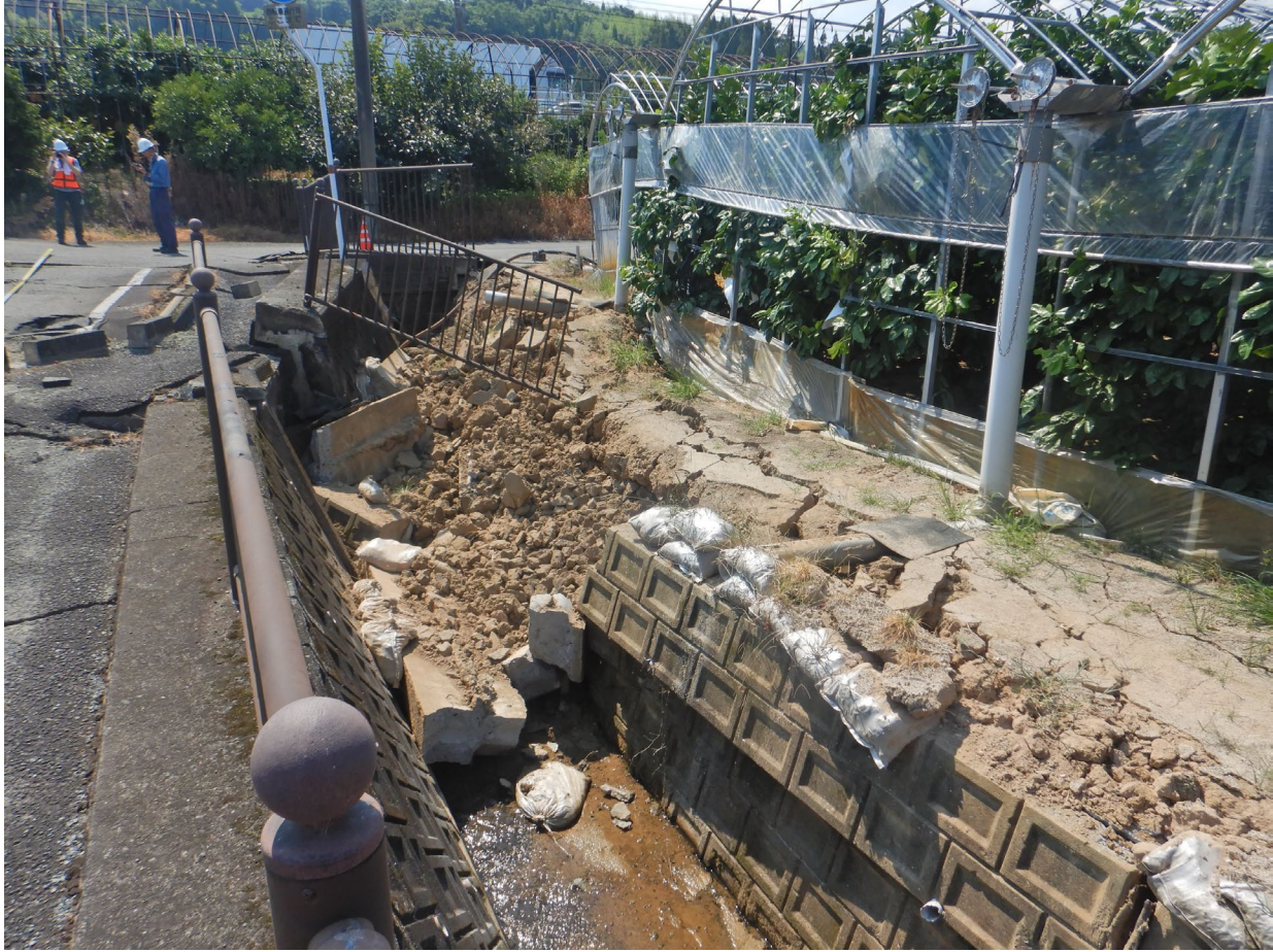
断層変位による農業用水護岸および果樹畑の崩壊
