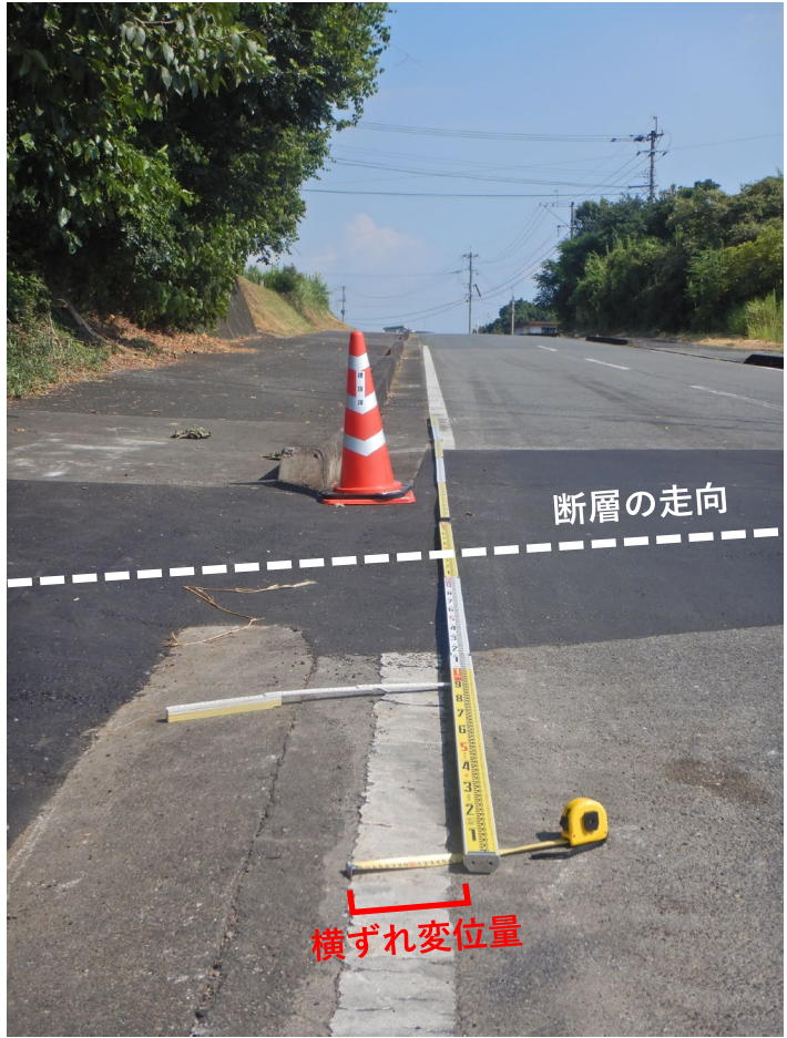
御船町平成音楽大学付近の道路に出現した断層変位 ここでの右横ずれ変位量は約17～18 cm
