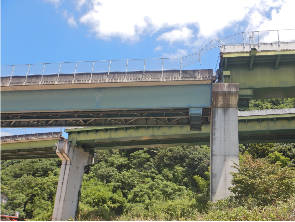
断層変位に伴う九州自動車道の橋脚の破断
