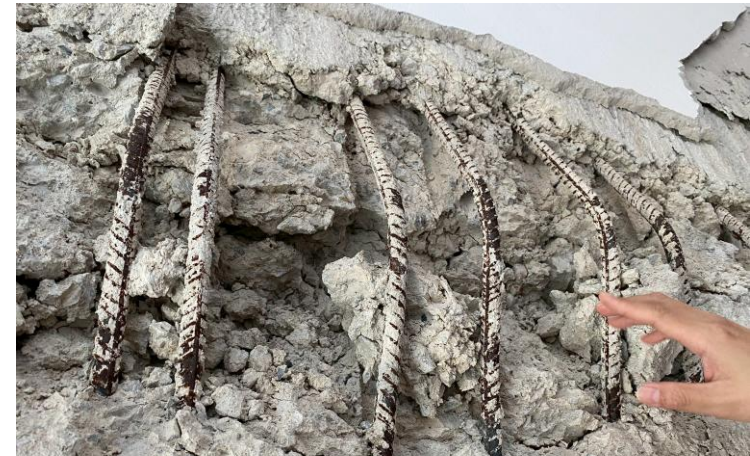
ภาพความเสียหายบริเวณผนังรับแรงเฉือน ฝั่งบันไดหนีไฟเหนือพื้นชั้น 3
