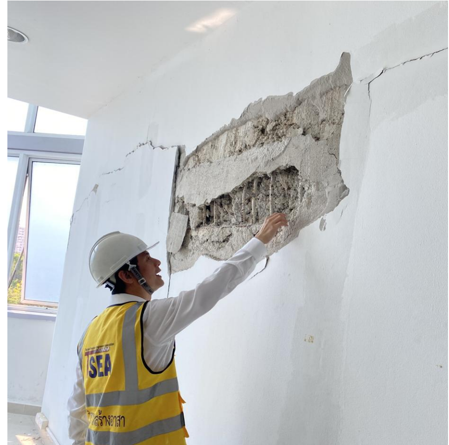
ภาพความเสียหายที่ผนังรับแรงเฉือน บริเวณผนังปล่องลิฟต์ชั้น 3
