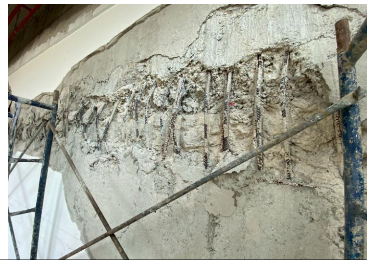
ภาพความเสียหายบริเวณผนังรับแรงเฉือน ฝั่งห้องประชุมเหนือพื้นที่ชั้น 3
