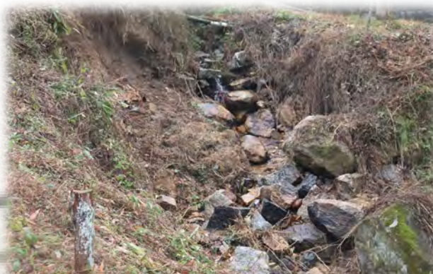
水路（「寺沢堀」）の石組みが崩れている
