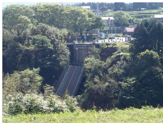
図 8 残った桁の一部（左岸：河陽側）
