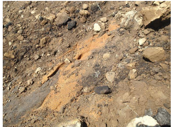
図 4 7 崩壊箇所内部の土
