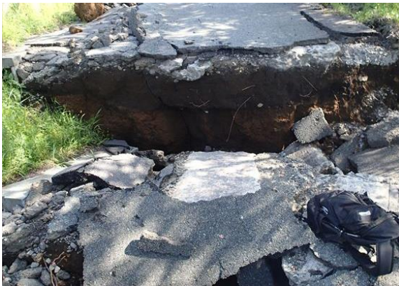
図 4 8 崩壊箇所内部の道路の段差
