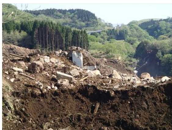
図 7 残った橋脚の一部（右岸：立野側）
