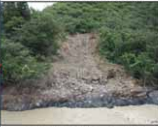
岩泉町松野地区の崩壊
