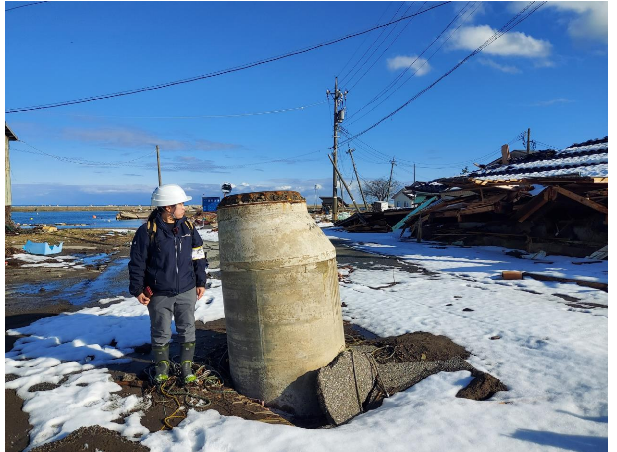
マンホール隆起状況
