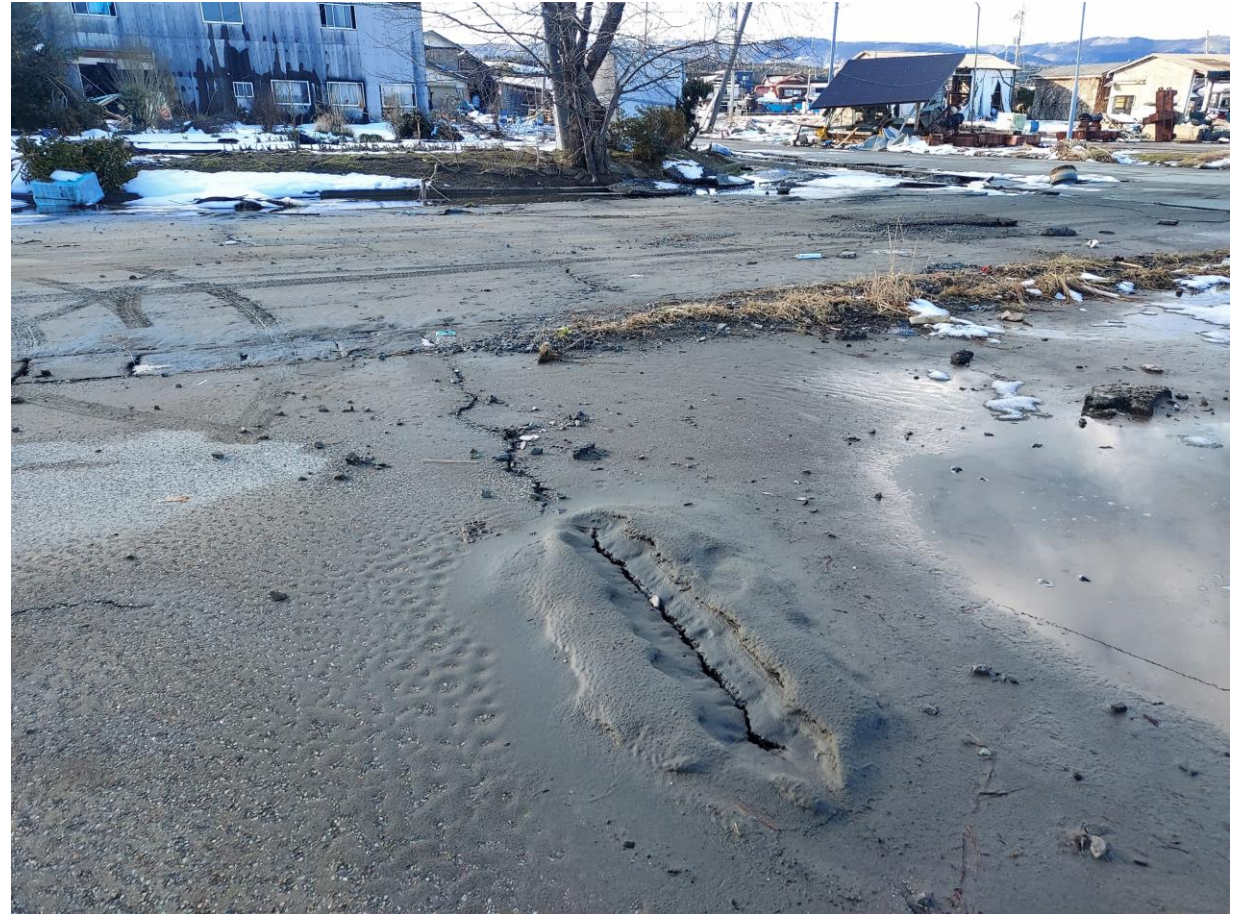
地割れからの噴砂状況
