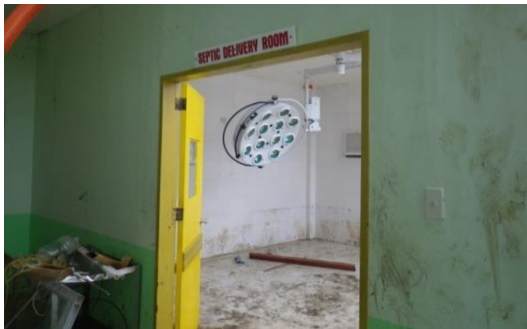
Leyte Provincial Hospital 手術室の被害状況
