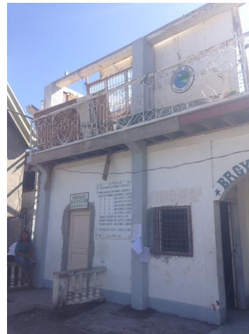
アルプエラのバランガイ 保健ステーション（被災）
